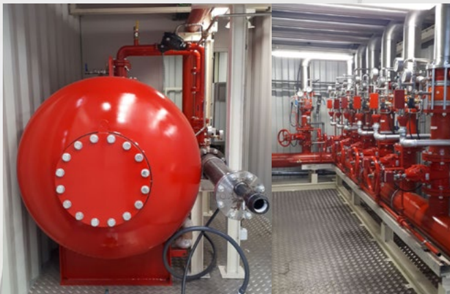
Überflutungsventile mit TRIM-Steuerung. Foamogen-Mischzentrum.
