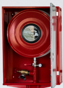
Pórtico para BIE con armario rígido.
